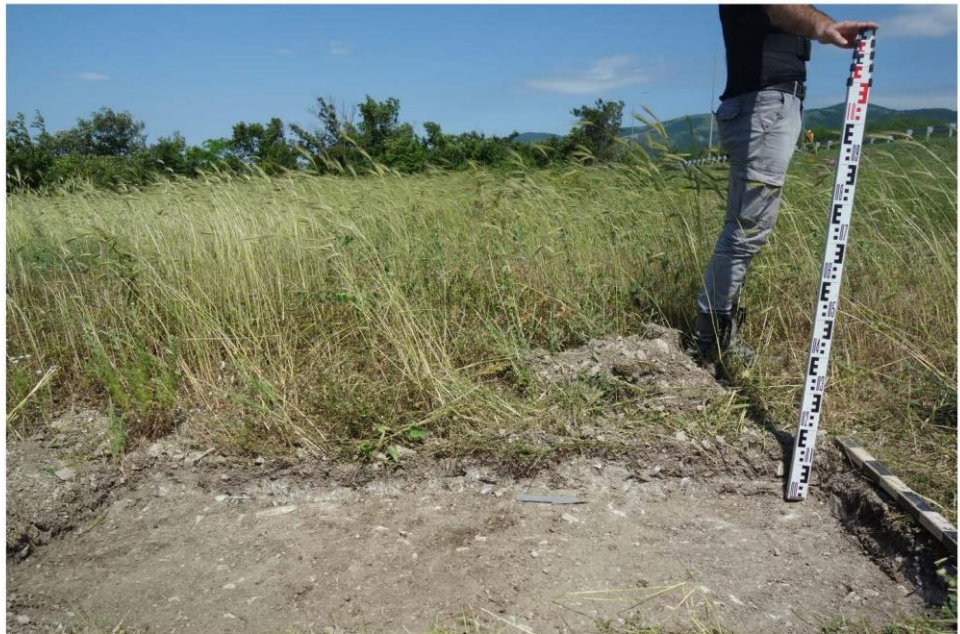
Рис. 31. Краснодарский край. Город-курорт Геленджик. Строительство примыканий в границах полосы отвода автомобильной дороги общего пользования федерального значения М-4 «Дон». Шурф 2. Профиль западного борта. Вид с востока.
