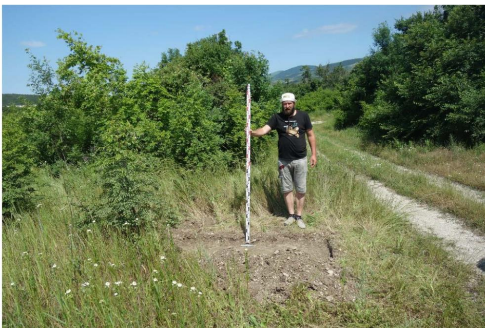
Рис. 26. Краснодарский край. Город-курорт Геленджик. Строительство примыканий в границах полосы отвода автомобильной дороги общего пользования федерального значения М-4 «Дон». Шурф 1 после окончания работ. Вид с востока.
